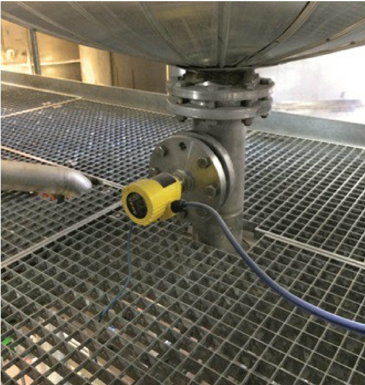
Capteur maître d'un système de mesure de pression différentielle électronique dans une cuve de distillation. Les solvants d'extraction des principes actifs sont récupérés dans une cuve de distillation d'environ 2,5 m de haut par évaporation à 50-60 °C sous vide (50 mbar absolus).
