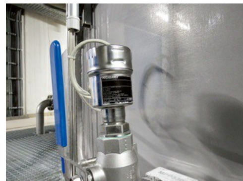
Point de mesure avec VEGABAR 82 et Second Line of defense.
