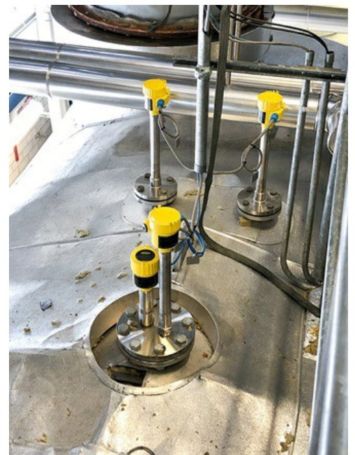
Die redundante Messung sorgt dafür, dass das Wasserniveau im optimalen Bereich arbeitet.
