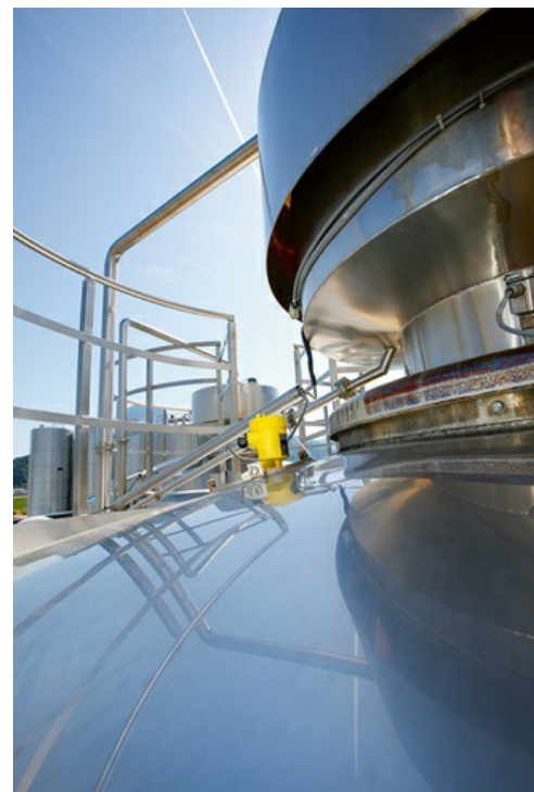
Il VEGAPULS 64 misura in maniera affidabile il livello nei serbatoi del siero di latte.
