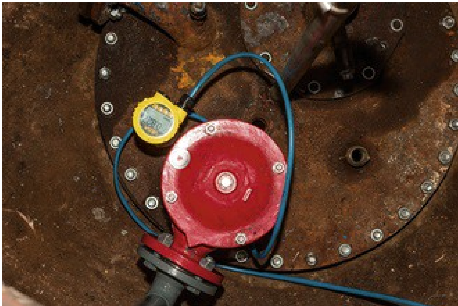
Compartiment d'une cuve souterraine de solvants, avec le capteur radar VEGAPULS 64.
