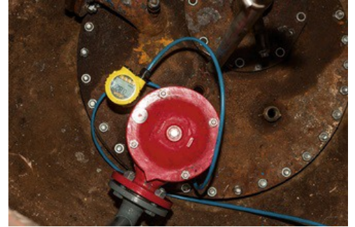
VEGAPULS 64 radar sensörlü bir yeraltı eritici madde tankının bölmesi
