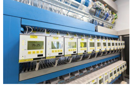
Yer altı eritici madde deposu için VEGAMET 324 değerlendirme cihazları ile donatılmış kumanda dolabı.
