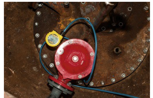
带有 VEGAPULS 64 型雷达传感器的地下溶剂罐内的腔室。
