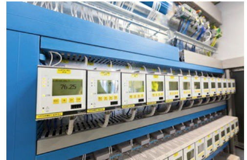
带 VEGAMET 624 型控制器的控制柜用于地下溶剂的仓储。
