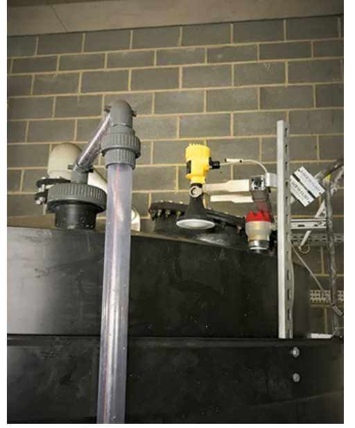
Depolama tankının üzerine monte edilen VEGAPULS 64 radar sensör, tankın içindeki hidroklorik asidin seviyesini tankın tavanından geçerek ölçüyor.
