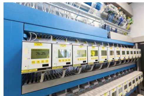
Armoire de commande avec les transmetteurs VEGAMET 624 pour le stockage souterrain de solvants.
