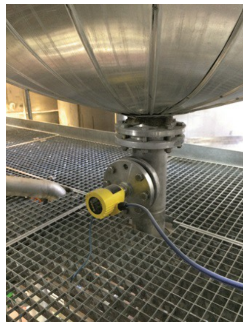
Sensore master di una misura elettronica di pressione differenziale in una caldaia di distillazione.
