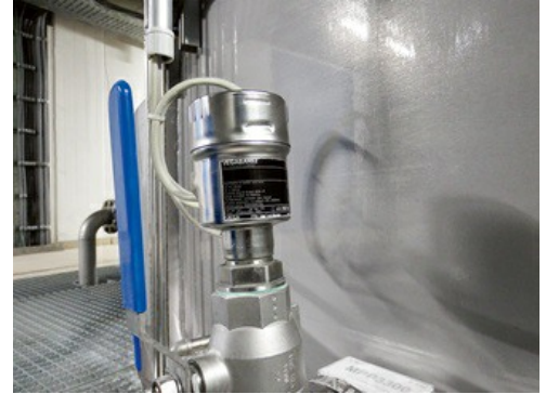
Messstelle mit VEGABAR 82 und „Second Line of Defense“.
