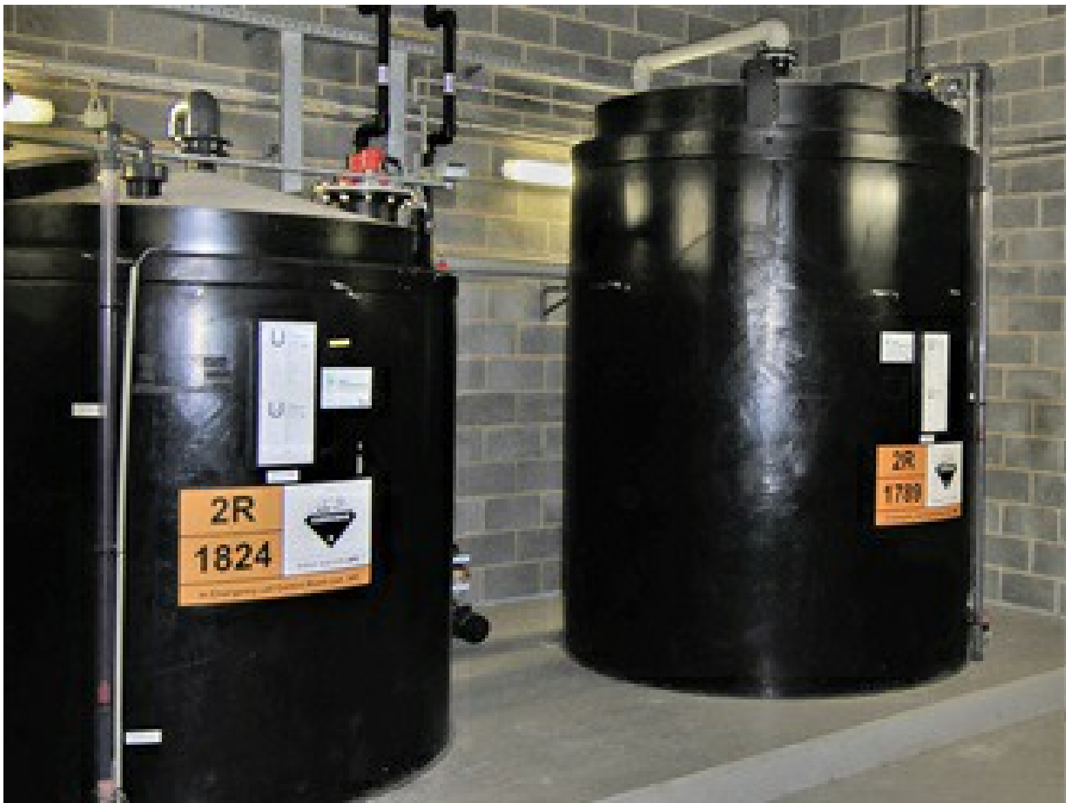
Cuve de stockage de produits chimiques acides ou alcalins.
