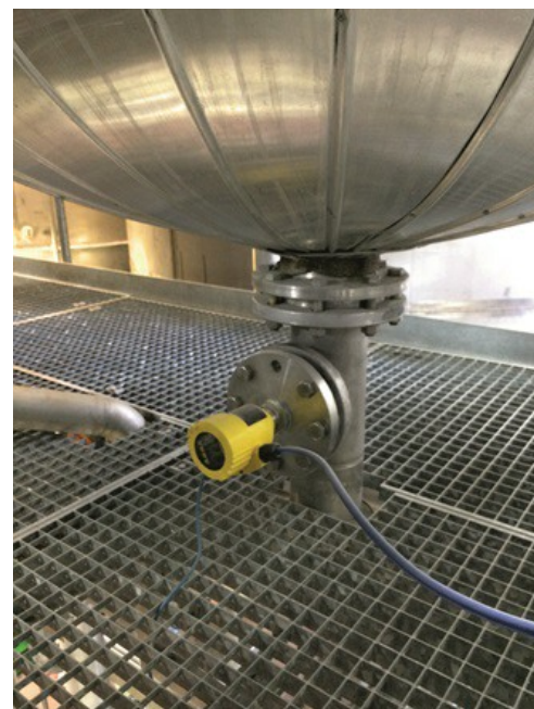
Capteur maître d'un système de mesure de pression différentielle électronique dans une cuve de distillation.
