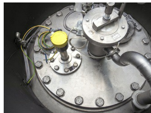
De radarniveausensor VEGAPULS 64 zorgt voor de inhoudsmeting.
