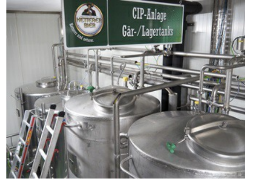
CIP tankında basınç ölçüm transmitterleri kullanılıyor.
