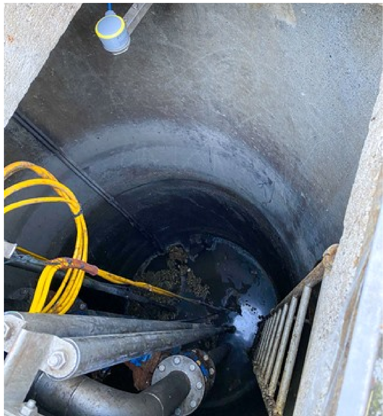
Le poste de relevage de Hart, un lieu exiguë
