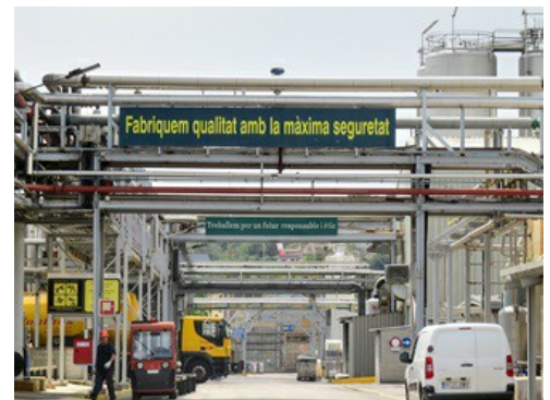
The factory premises of Croda Ibérica SA at the Fogars de la Selva site (Barcelona).
